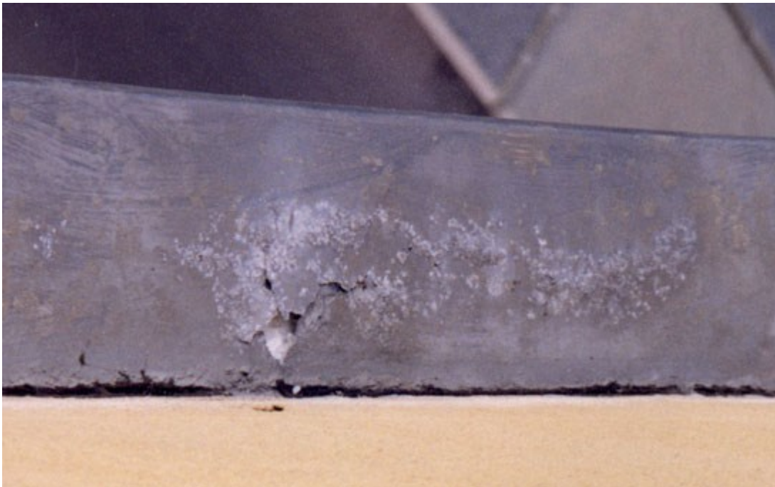
Korozní poškození "titanzinkového" plechu na parapetu obytné budovy po dvou letech
