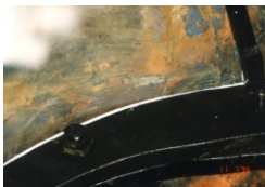
Izolační páska, bránící zvýšené korozi železné kostry vlivem kontaktu s měděným pláštěm po degradaci nátěrového systému
