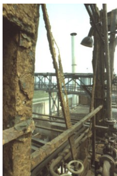
Atmosférická koroze ocelové konstrukce v chemickém závodě
