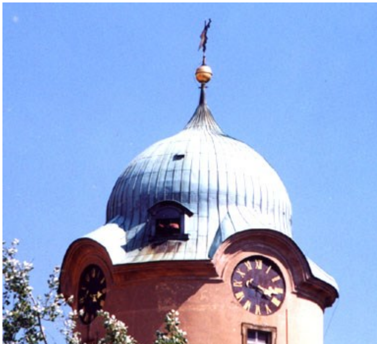
Patina na kopuli věže zámku v Poděbradech, vzhledově poškozená korozními produkty železa (pod vikýřem)
