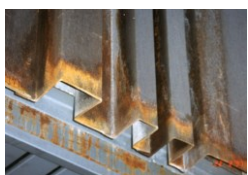
Detail nevhodného ukončení fasády z patinující oceli
