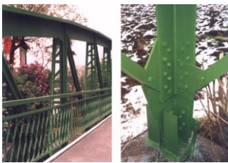
Vlevo: protikorozní ochrana ocelového mostu nátěrovým systémem; vpravo: protikorozní ochrana ocelového sloupu vysokého napětí nátěrovým systémem (převzato Tupraco s.r.o. Praha)
