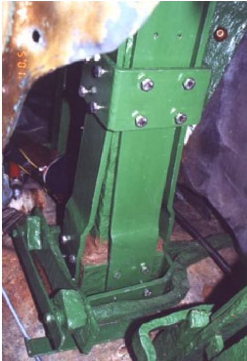
Hlavní nosník vrcholového sousoší na Čestném sloupu Nejsvětější Trojice v Olomouci po opravě
