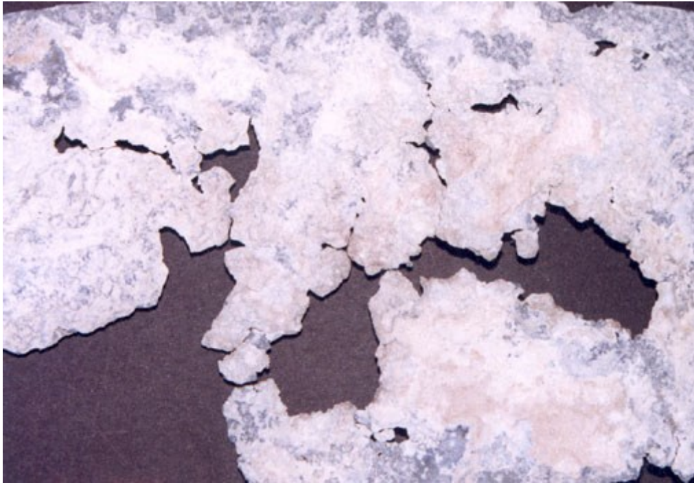
Korozní poškození "titanzinkového" plechu na parapetu obytné budovy po dvou letech (vnitřní povrch)
