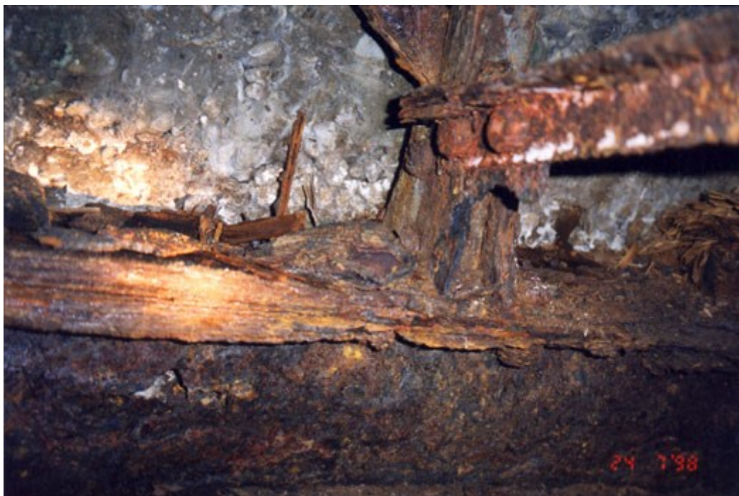
Korozní poškození železné konstrukce pod sousoším Trig na Národním divadle v Praze
