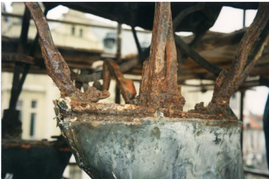
Koroze železné konstrukce na soše Jiřího z Poděbrad v místě zdržování srážkové vody
