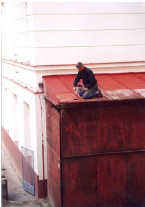
Příklad běžného způsobu nanášení nátěru na nedokonale očištěný povrch oceli
